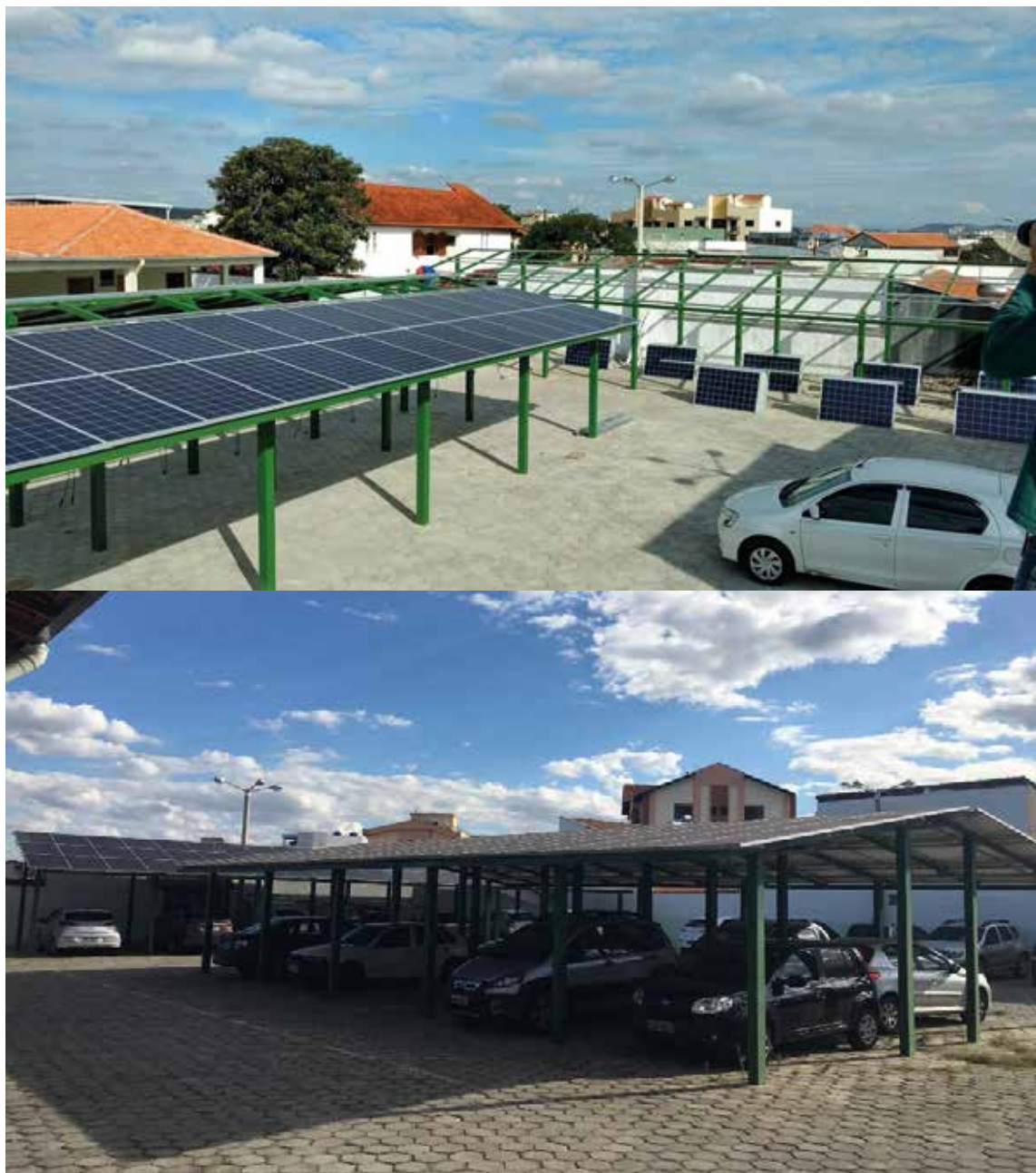
Figura 58 – Estacionamento da Reitoria com placas fotovoltaicas 29
