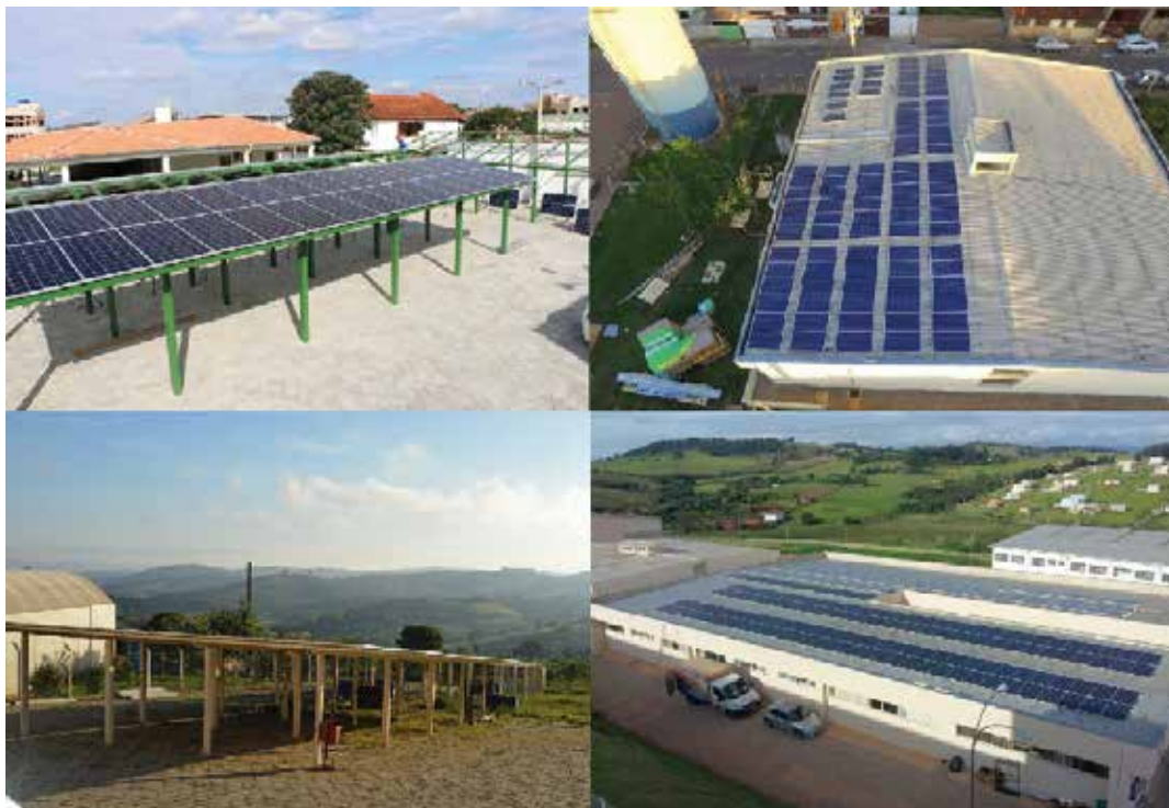
Figura 72 – Placas fotovoltaicas instaladas nas unidades do IFSULDEMINAS
