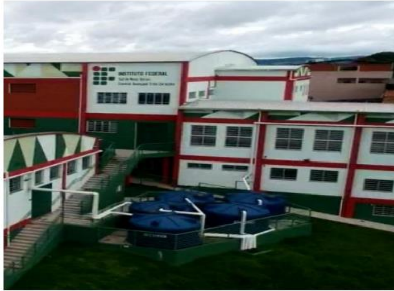
Figura 9 - Estação de coleta de águas pluviais (Unidade II)
