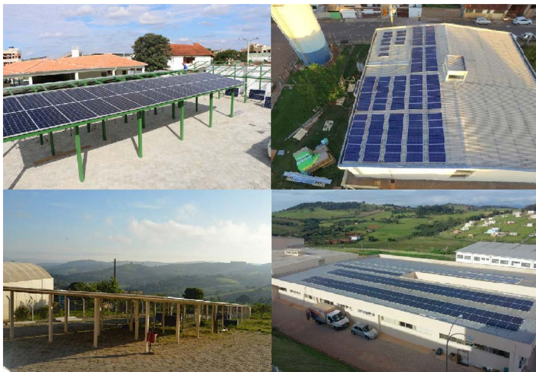
Figura 72 – Placas fotovoltaicas instaladas nas unidades do IFSULDEMINAS
