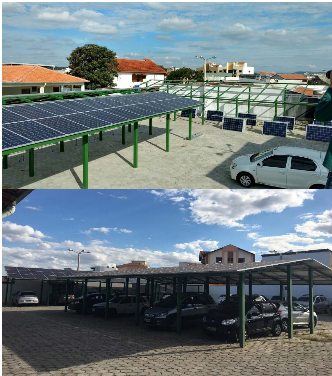
Figura 58 – Estacionamento da Reitoria com placas fotovoltaicas 29
