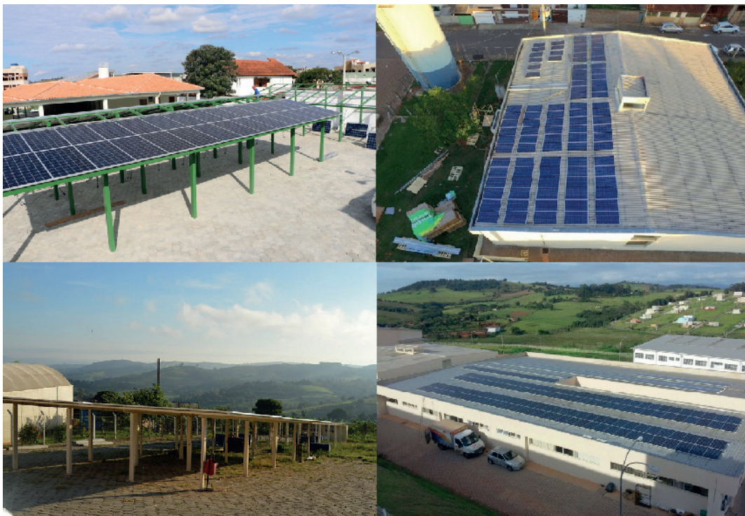
Figura 73 – Placas fotovoltaicas instaladas nas unidades do IFSULDEMINAS
