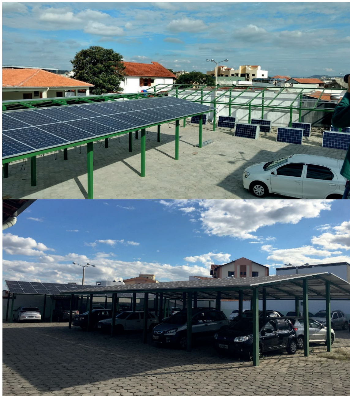
Figura 59 – Estacionamento da Reitoria com placas fotovoltaicas 29
