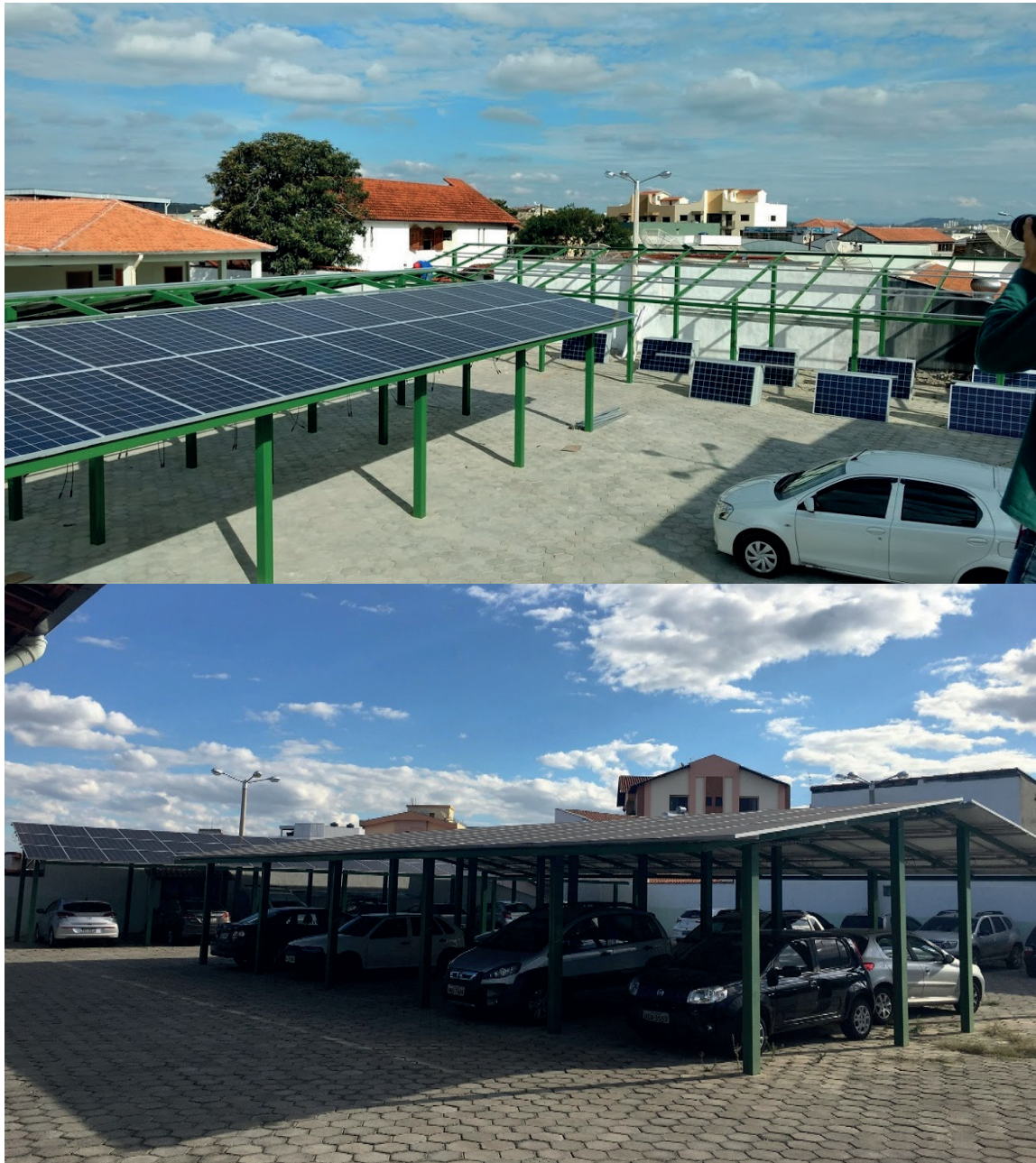
Figura 59 – Estacionamento da Reitoria com placas fotovoltaicas 29
