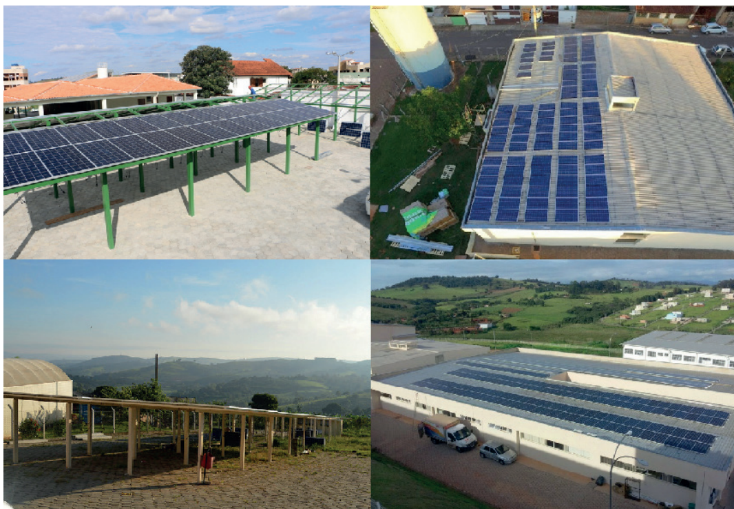
Figura 73 – Placas fotovoltaicas instaladas nas unidades do IFSULDEMINAS
