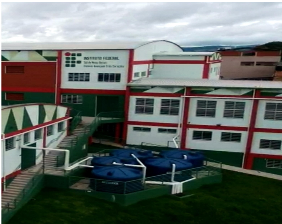
Figura 8 - Estação de coleta de águas pluviais (Campus II).
