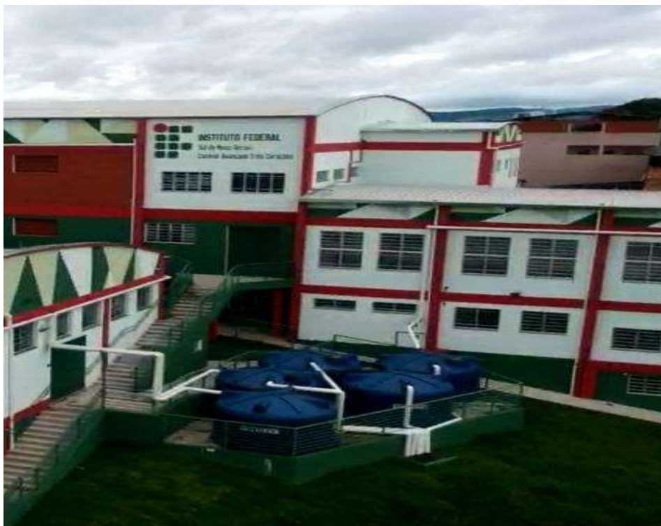
Figura 9 - Estação de coleta de águas pluviais (Campus II).
