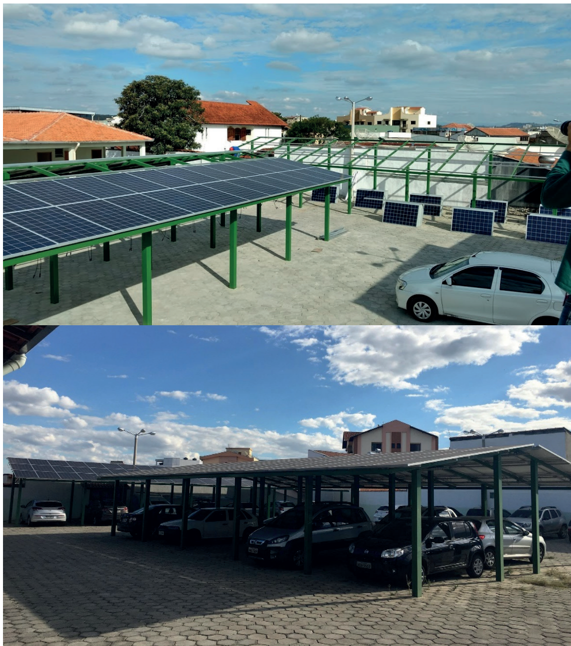
Figura 59 – Estacionamento da Reitoria com placas fotovoltaicas 29
