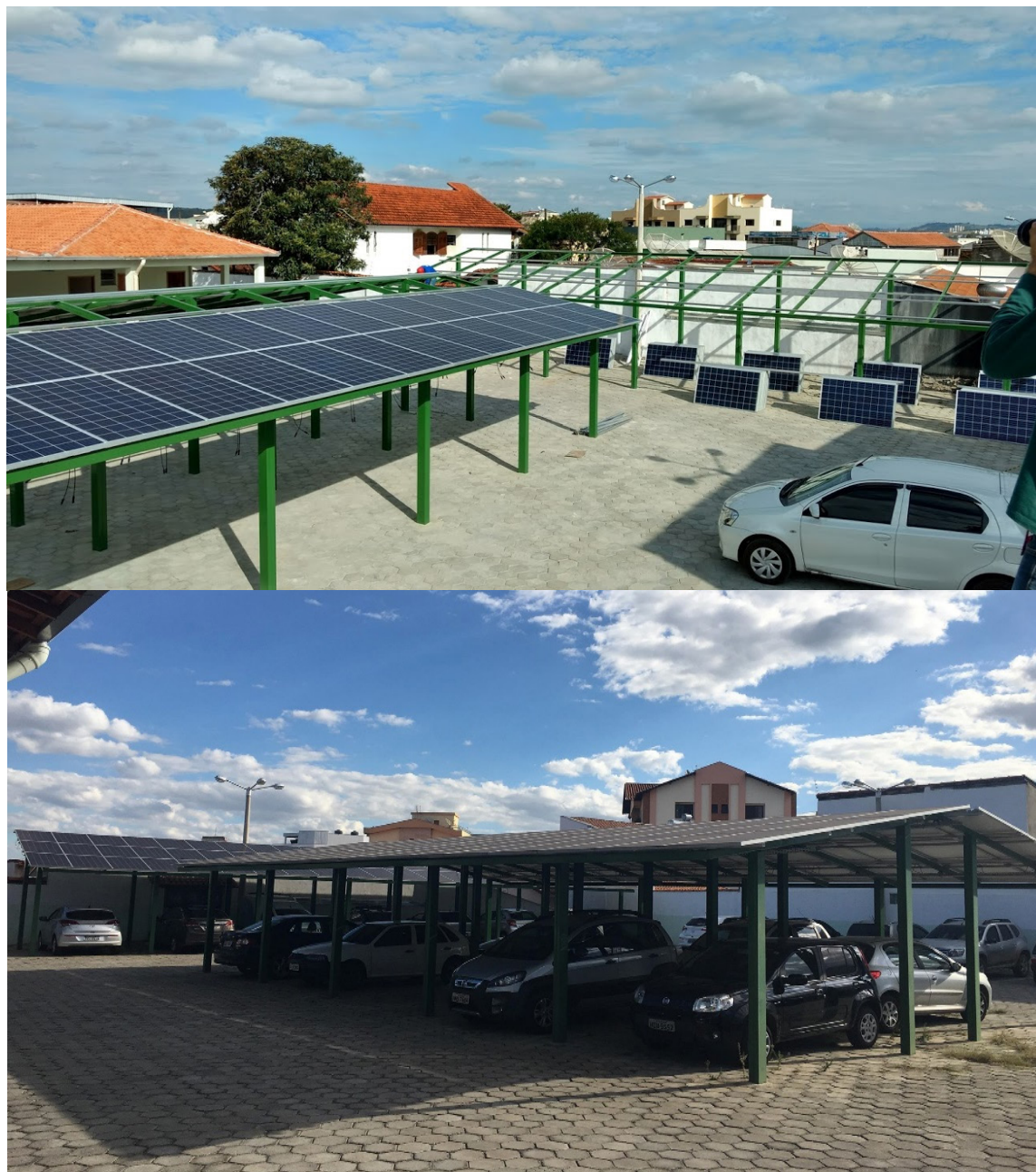
Figura 59 – Estacionamento da Reitoria com placas fotovoltaicas 29
