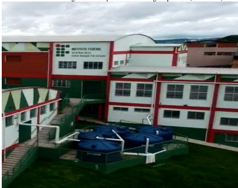
Figura 9 - Estação de coleta de águas pluviais (Unidade II).
