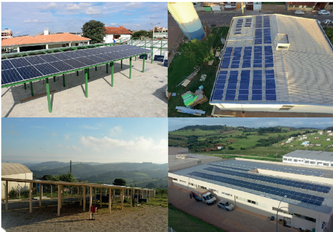
Figura 73 – Placas fotovoltaicas instaladas nas unidades do IFSULDEMINAS
