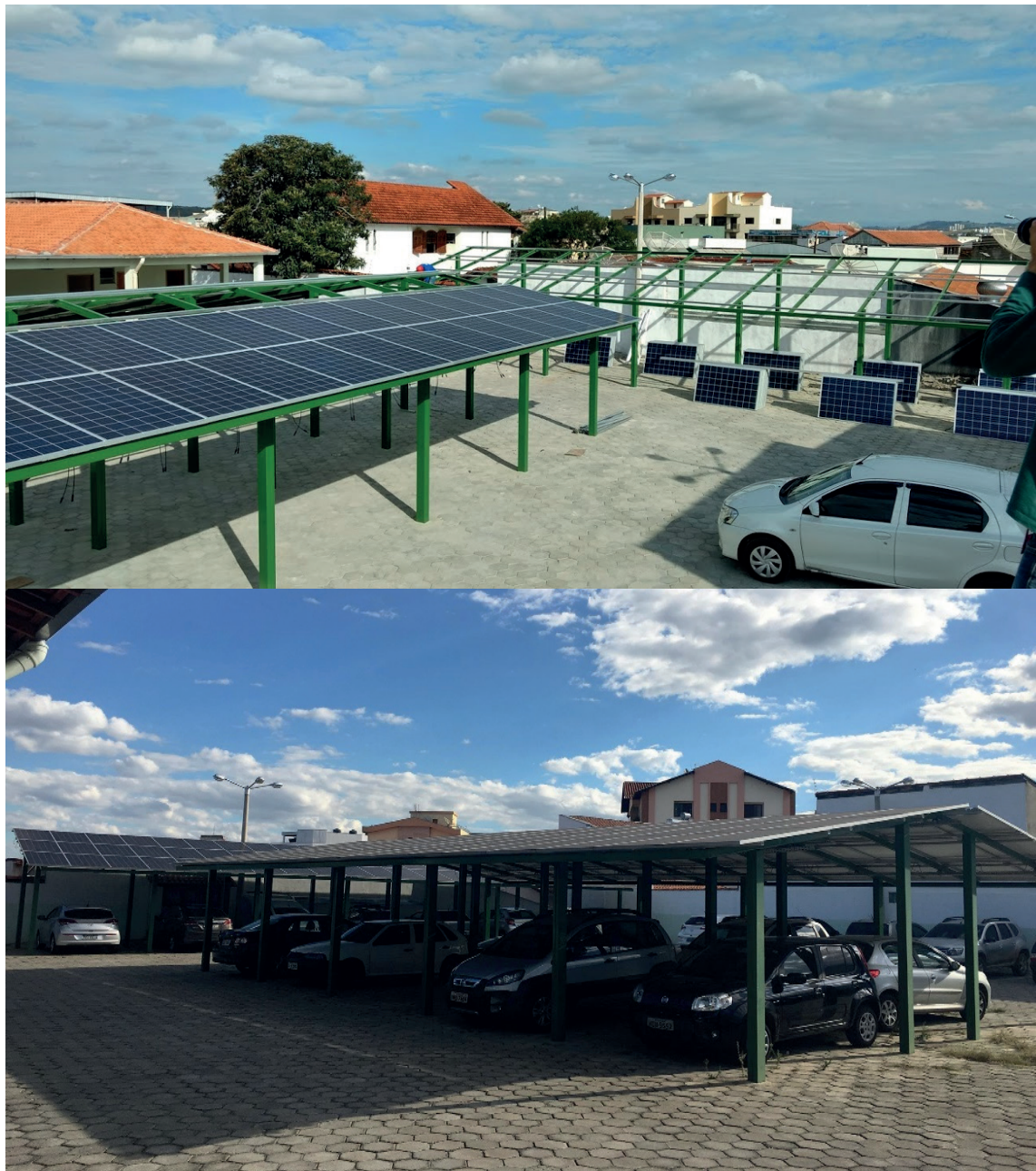
Figura 59 – Estacionamento da Reitoria com placas fotovoltaicas 29
