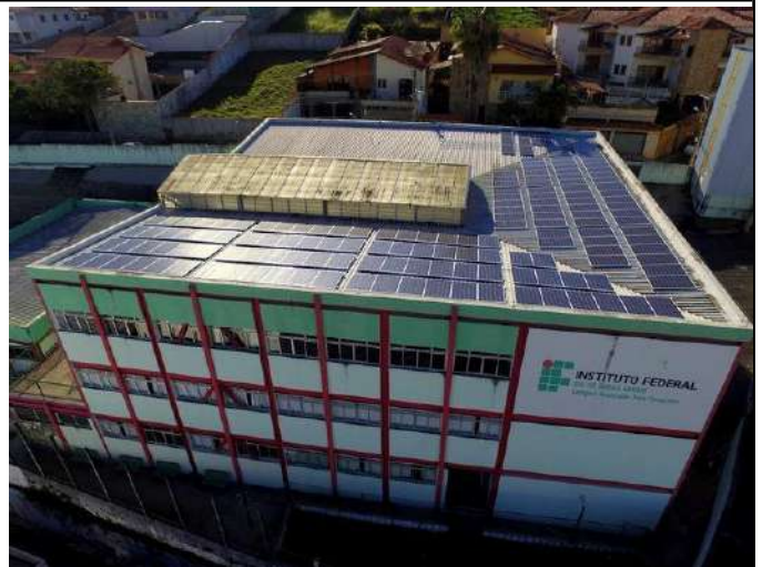
Figure 8: Campus Três Corações solar power plant.
