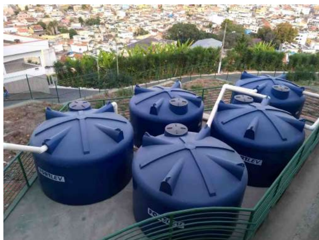
Figure 12: Três Corações Campus rainwater reservoir tanks.
